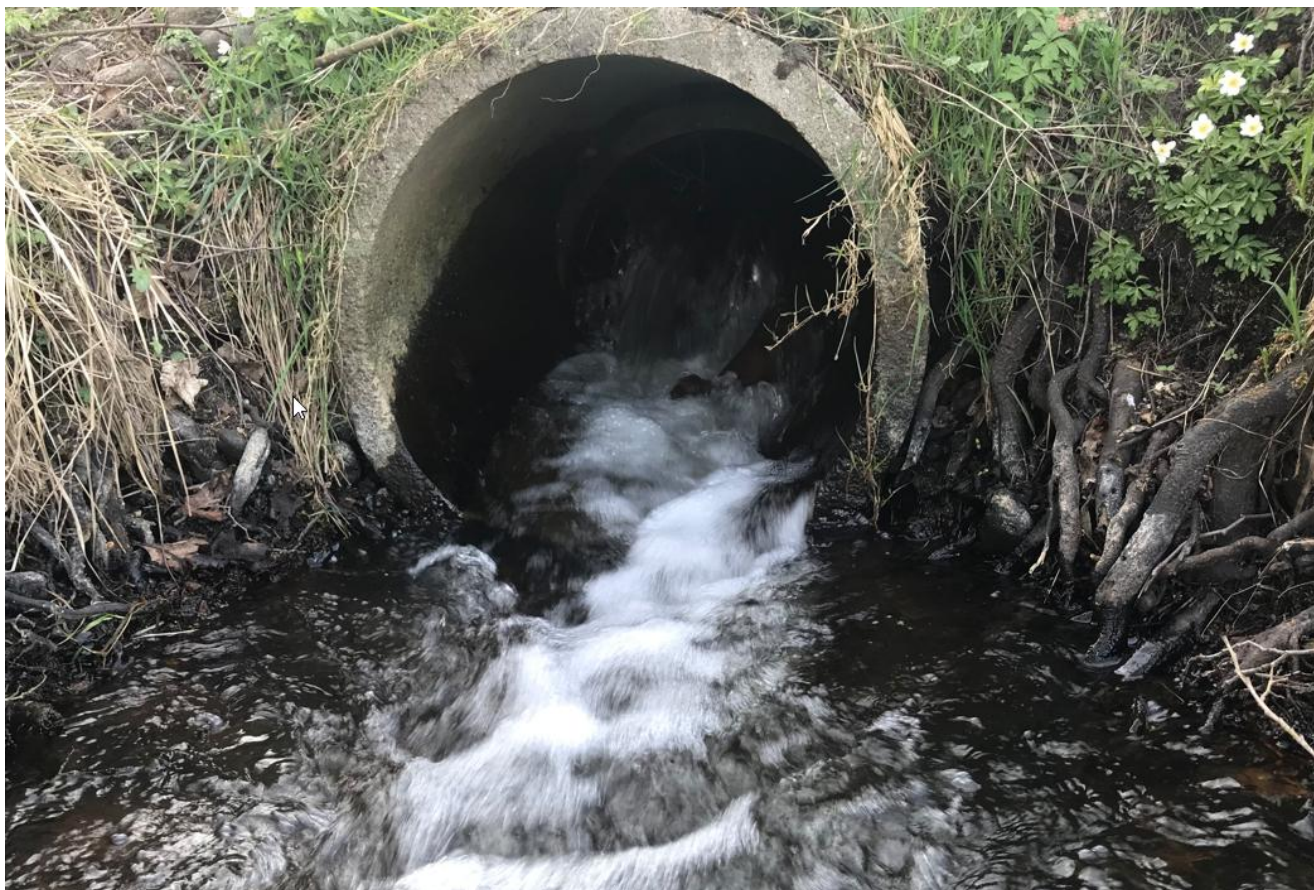
Tilstopning inde i røret spærrer for fisks opstrøms passage ved Porskærvej. April 2020.
