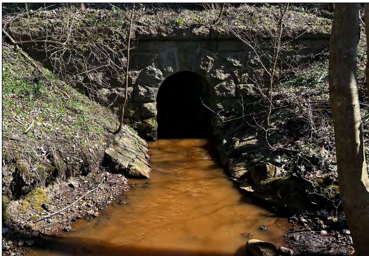
Figur 6: Indløb under det gamle jernbanelegeme i st. 924 m. Den særligt kraftige okkerbelastning skyldes formentlig, at der var foretaget en "forstyrrelse" i den rørlagte del af vandløbet længere opstrøms, hvilket frigav en del okker, der var ophobet i en brønd.
